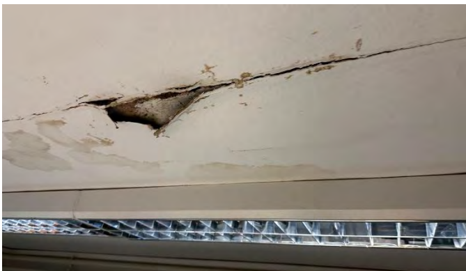
Im Schulbüro tropft es wegen der OGS-Baustelle von der Decke.
