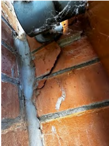
Die Halterung der Sprossenwand fällt fasst aus der Wand.
